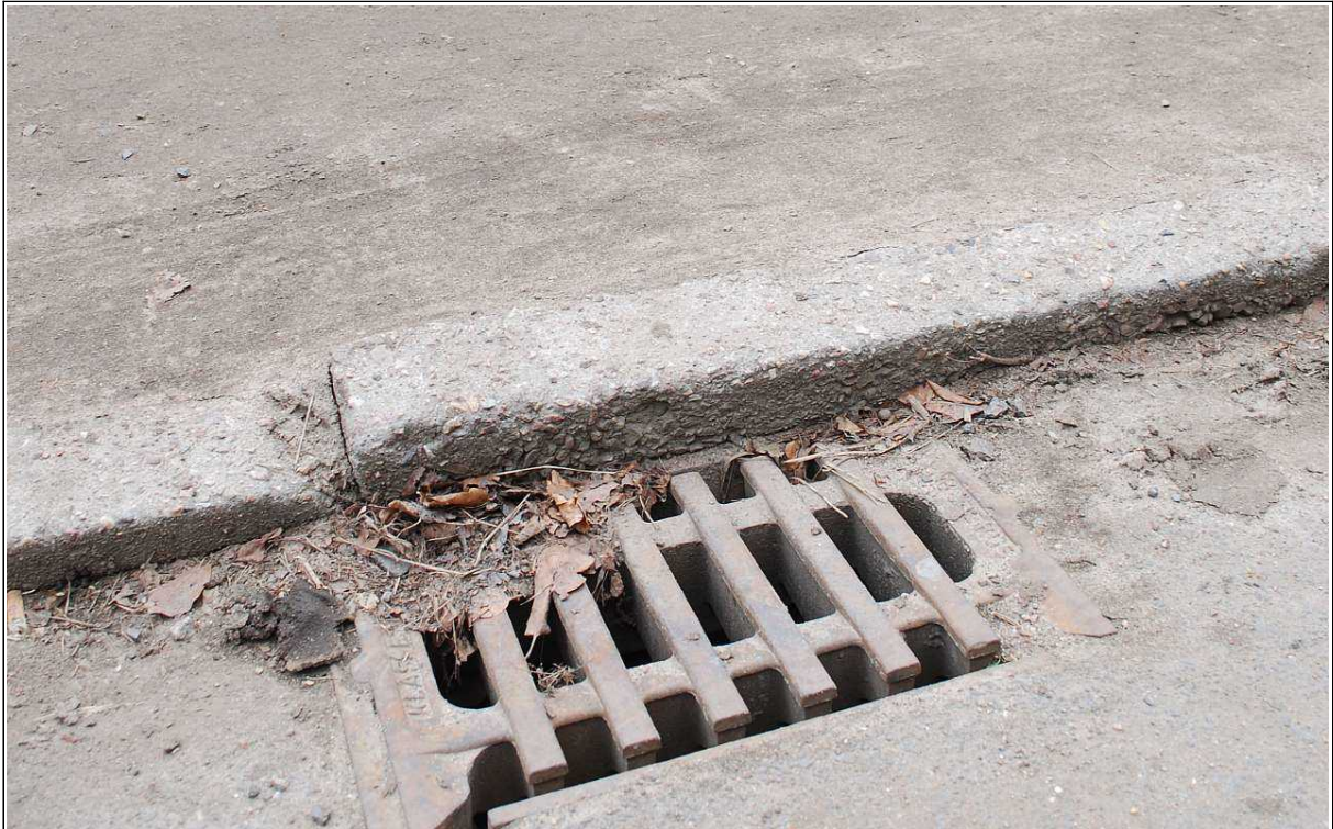
Abbildung 9: Gulli im östlichen Verlauf des Falkensteiner Ufers
